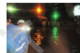
شکل ۱۰- هجوم آب گل و لای در زمان حفاری تونل‌ها
